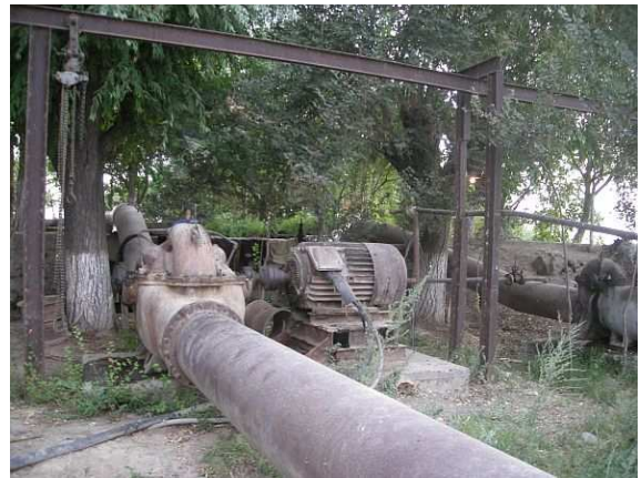
Pumpstation zur Bewässerung in Tadschikistan
